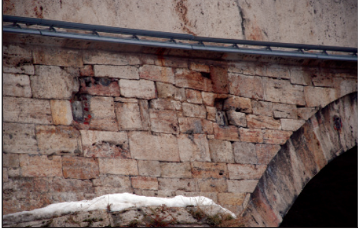
İnce yonu taşlarının derzleri.
