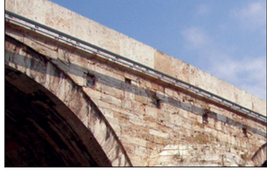
Tempan duvarlarının yaralı bereli görünümü.
